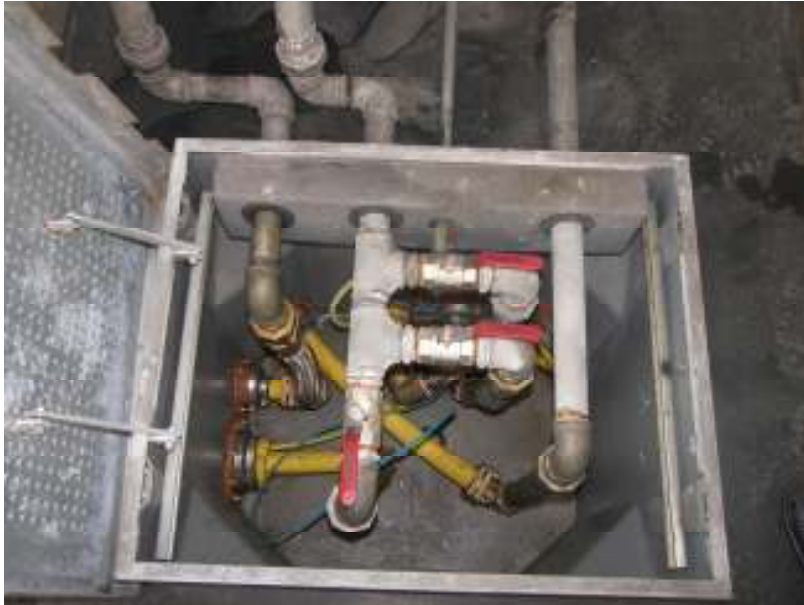
SUMP DE FILTRO DE DIESEL
