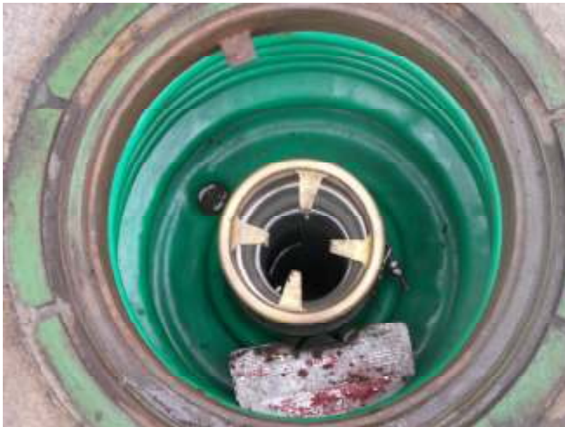
BOCA DE DESCARGA SELADA COM SPILL
