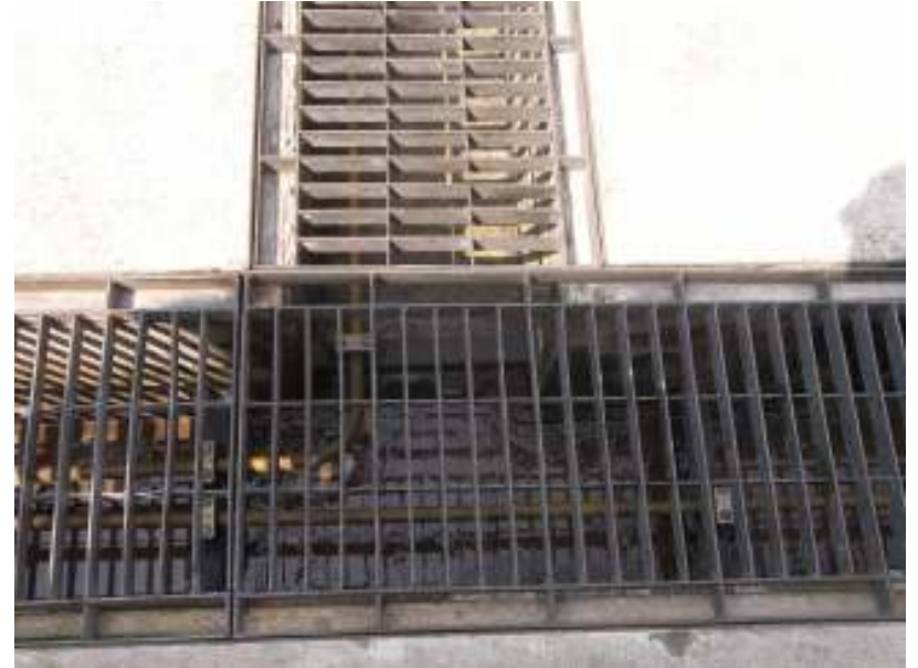
CANALETAS DE GNV
