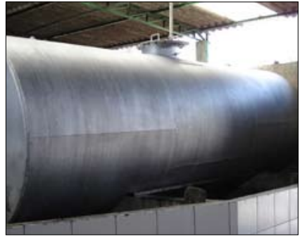
Tanque horizontal em bacia de contenção
